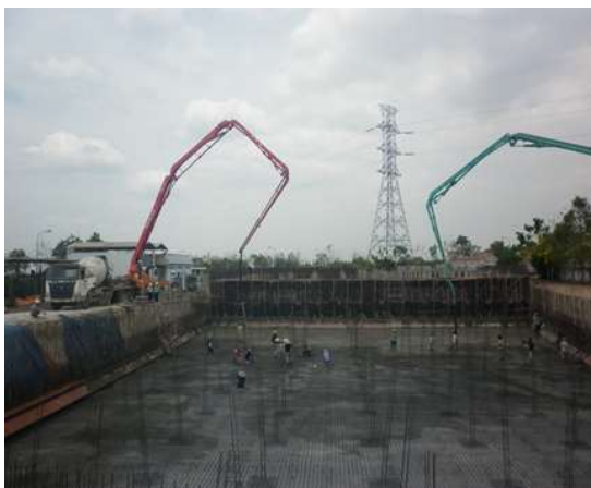
Bể xử lý nước thải KCN AMATA
