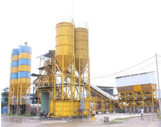
Trạm trộn Hố Nai công suất 195m 3 /h
